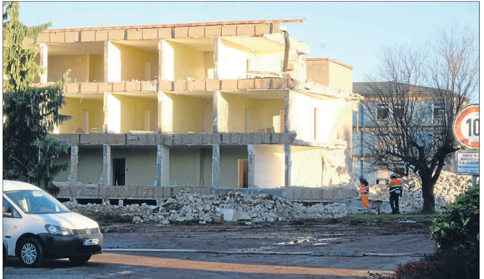
Nach und nach machen Baumaschinen die Internatsgebäude des früheren Vinzenz-Pallotti-Kollegs in Rheinbach dem Erdboden gleich. FOTOS: AXEL VOGEL
