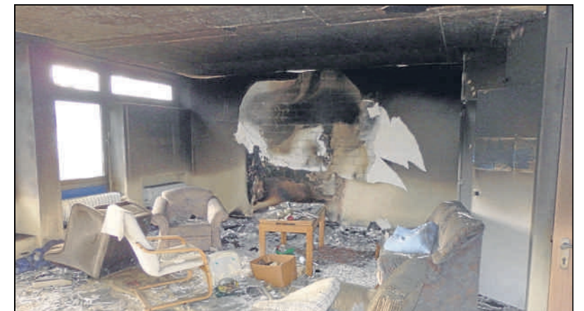
Die seit Jahren leerstehenden Internatsgebäude waren in vergangener Zeit häufig das Ziel von Vandalismus und Brandstiftung. FOTO: PALLOTTINER
